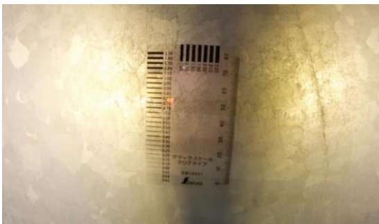
ELIOS2によって撮影されたパイプとクラックスケール
