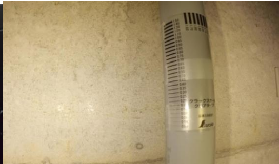
ELIOS2によって撮影されたトンネル内のクラックスケール
