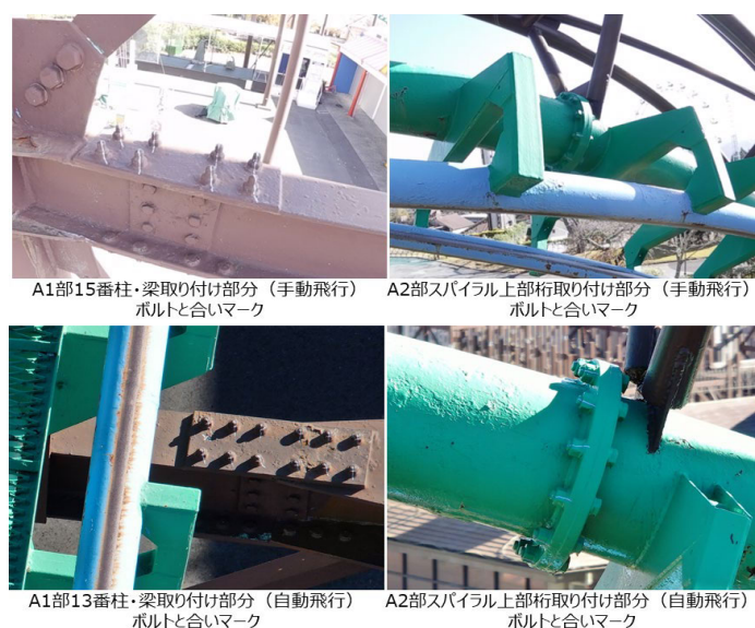
図7 ドローン撮影によるジェットコースター締結部の状況
